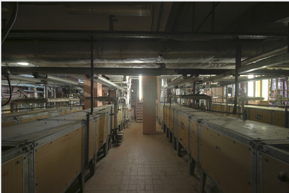
Technológia v podzemí budovy.
