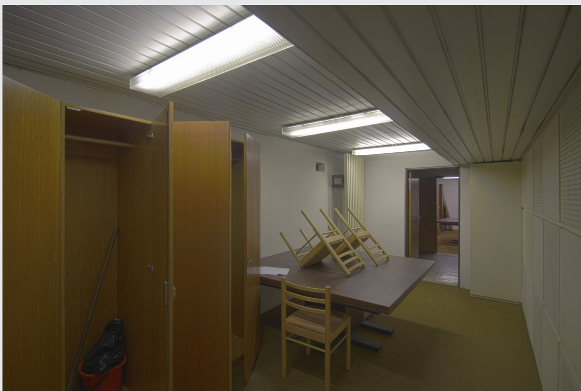
Poradné miestnosti, nachádzajú sa medzi objemom všetkých sál vytvárajú jadro pre pohyb súdu.
